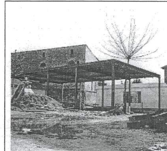
L'ala del CNUCE in via di allestimento per ospitare il sistema IBM 360/67
